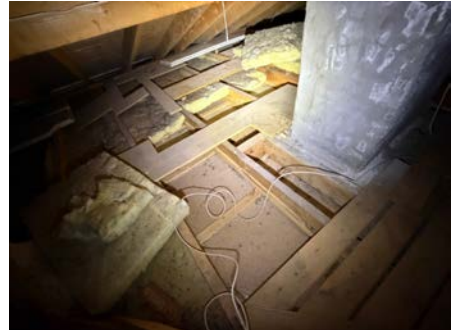
Eksempel på manglende isolasjon i loftbjelkelaget.
