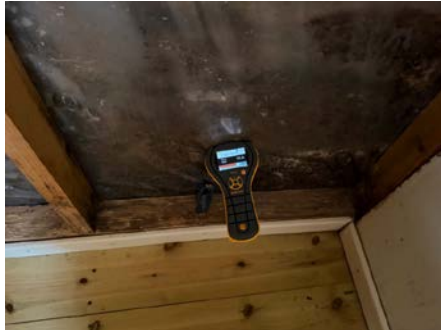
Fuktskadet vegg i dusjen.
