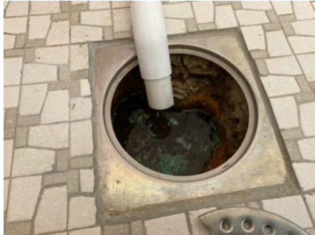
Sluk av soil/støpejern.
