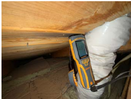
Fuktmåling på loft over tilbygg.
