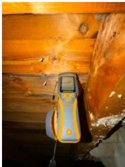
Fuktmåling på loft over orginaldel.
