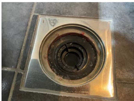
Sluk under dusjkabinett.
