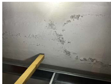
Saltutslag på vegg i kjellerrom.
