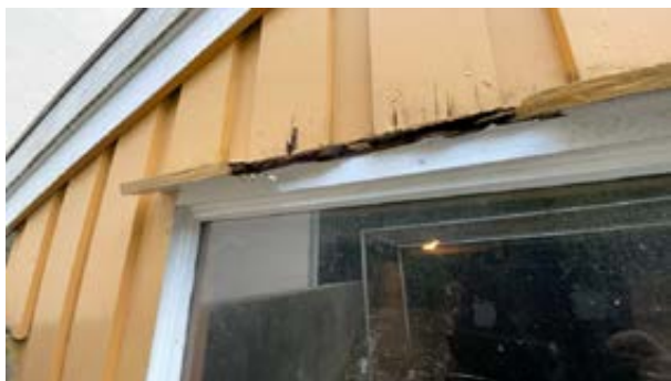
Råteskader på vannbrett over vindu.
