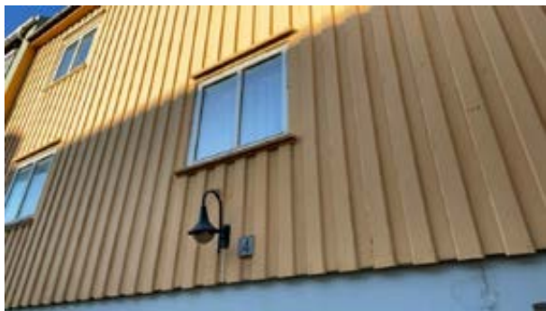
Vindu uten beslag/lufting.
