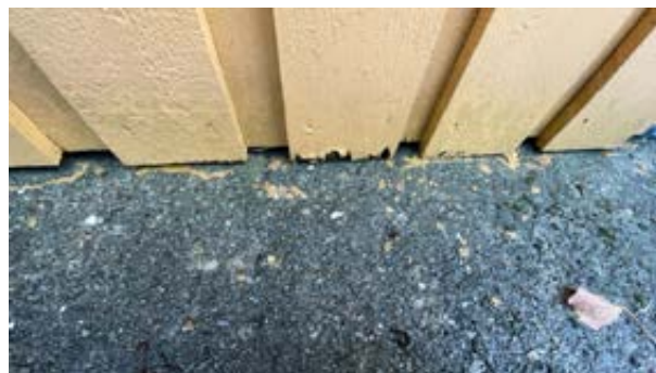
Stedvis råteskadet kledning.
