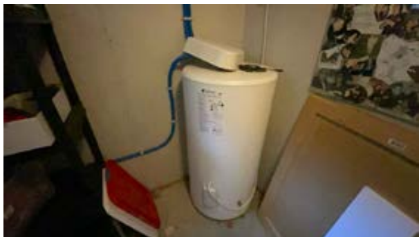
Varmtvannsbereder i bod sokkeletasje.
