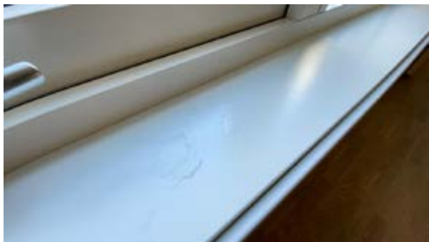
Svell/fuktskader på utforing.
