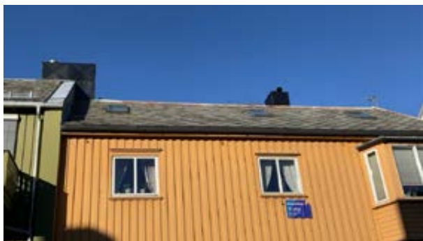
Manglende snøfanger mot offentlig fortau
