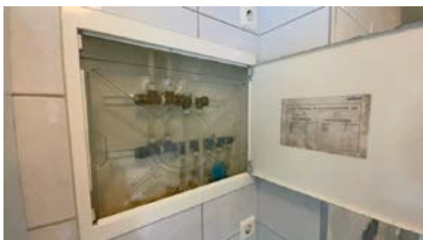
Rør i rør sentral.
