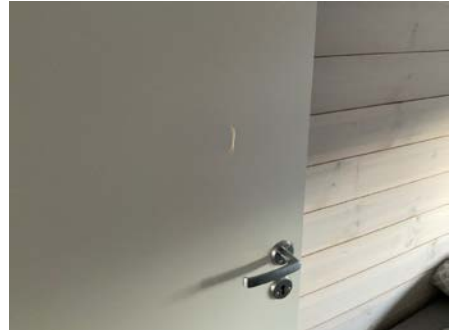
Skade i dørblad til det ene soverommet.
