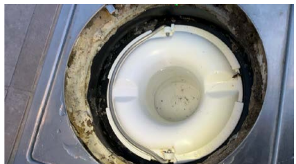
Sluk hovedbad i 1. etasje
