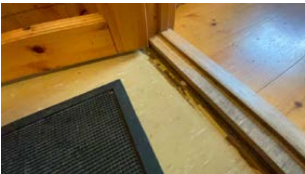
Sprukket belegg flere steder.
