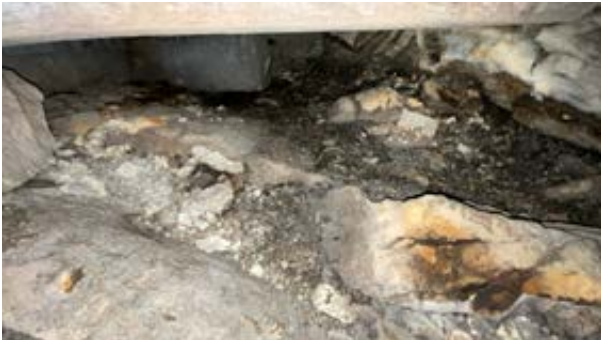
Tegn på vanninnsig mot nord.
