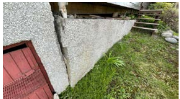
Grunnmur under terrasse er skjev grunnet marktrykk.
