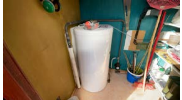
Varmtvannsbereder er plassert i ekstern bod.
