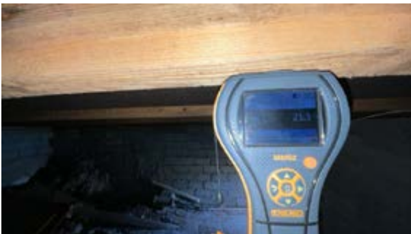
Det ble målt 21,3 vekt%fukt i bjelkelag.
