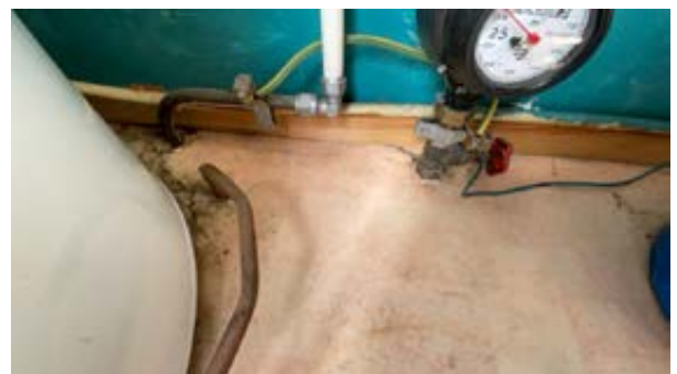
Vannkrane før vannmåler er ikke funksjonell.
