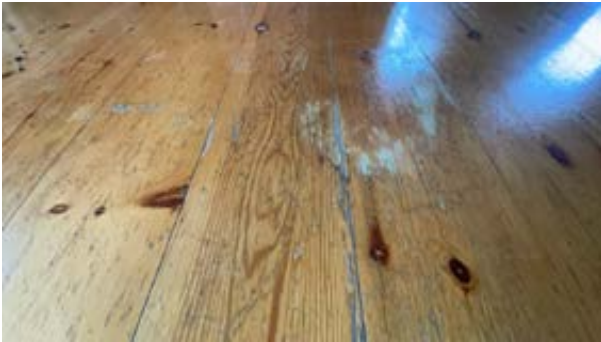
Sår/sprekker etter bruk
