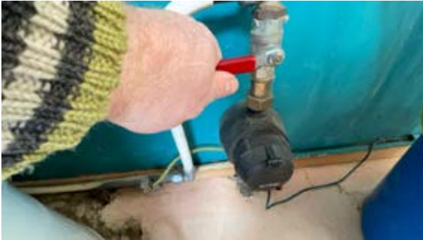
Vannkrane etter vannmåler fungerer.
