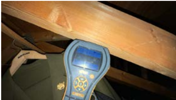
Fukt ble målt til under 7 vekt%.
