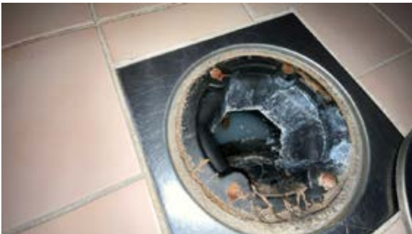
Plastsluk i dusjnise, ikke synlig tettesjikt grunnet slukens utforming.
