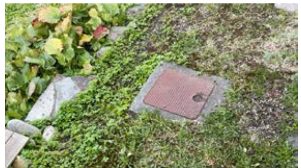
Utvendig kum for stikkledninger.
