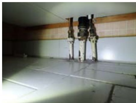
Rørgjennomføring i gulv. Ikke synlig mansjett/membran rundt rørene.
