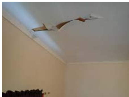
Skader i tak-strie
