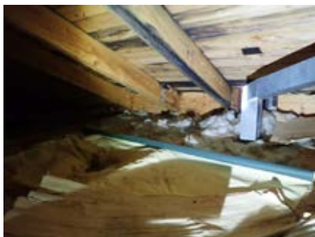
Fuktskader i takkonstruksjon og trobord
