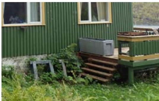
Trapp opp til altan - uten rekkverk.
