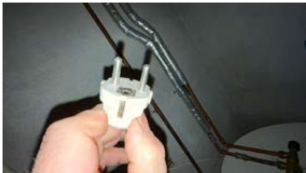
Ingen svimerker på stikk ved befaring.
