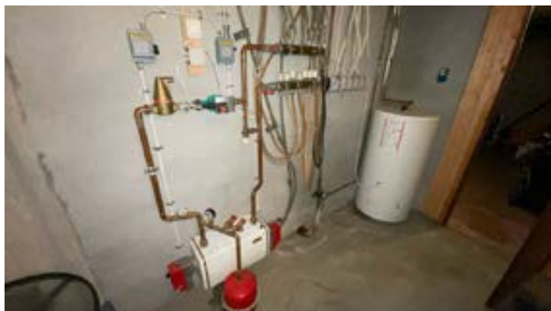
Sentral/fordelingsanlegg i vaskerom/teknisk rom.
