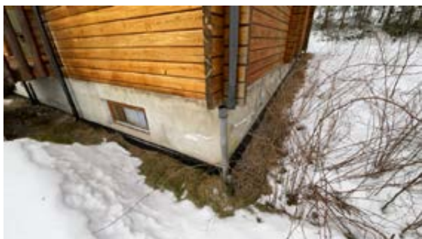
Nedløp går ikke ned i oppstikk.
