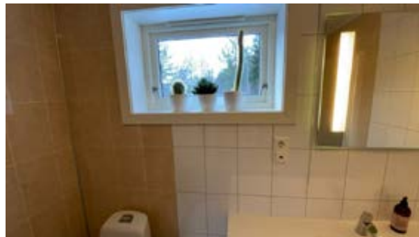
Vindu i våtzone over vask/innredning.
