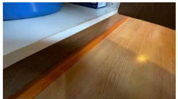
Antydning til mindre svell i skap under vask.
