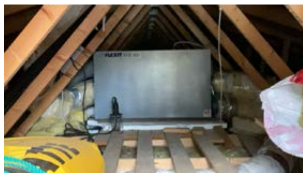
Ventilasjonsaggregat plassert på kaldloft.
