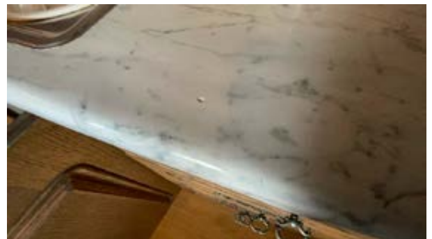
Mindre hakk/skader i overflate på benkeplate.
