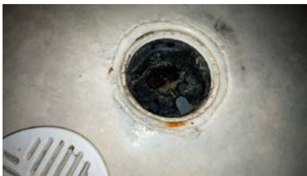
Belegg/tettesjikt er ikke under klemring og trekker fukt under belegg/tettesjikt
