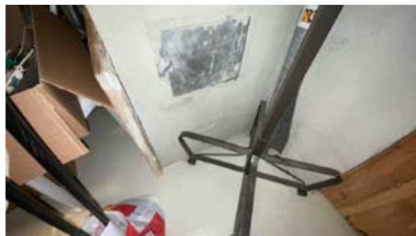
Sotluke i kjeller.
