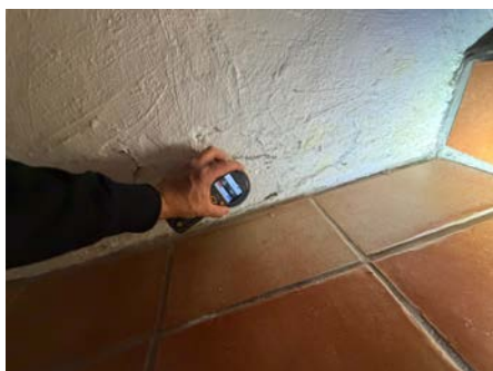
Referansemåling. Utslag på fukt på vegg ned mot gulv, ikke utslag på fukt i øvre del av vegg. Forsterker teorien om kapillært oppsug fra grunn.
