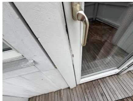
Skade i balkongdør.
