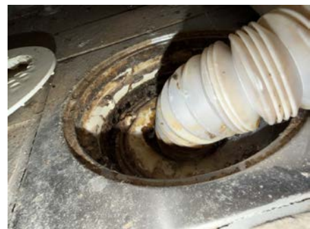
Sluk under dusjkabinett.
