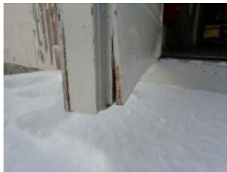
Skade i hovedinngangsdør
