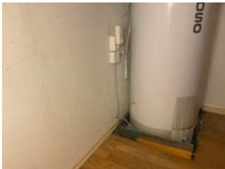
Varmtvannsbereider plassert i bod under trapp.
