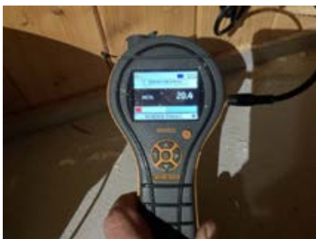
Ved piggmålig målt 20,4 vekt% fukt i bunnsvill.
