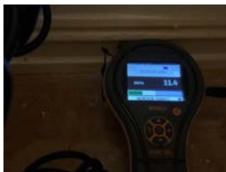
Piggmåling viste 1,4 vekt% fukt i bunnsvill.
