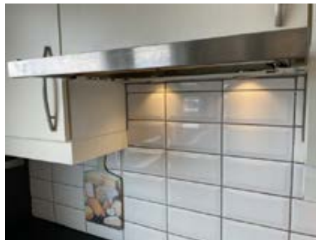
Ventilator på kjøkken.
