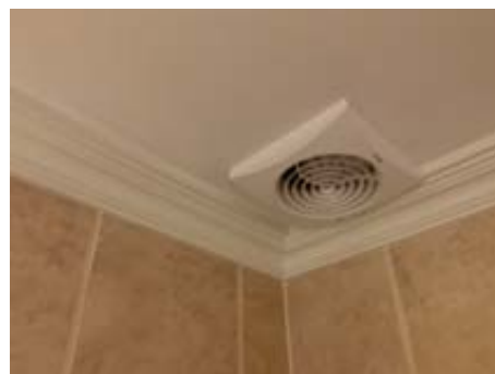
Elektrisk avtrekksvifte i tak.
