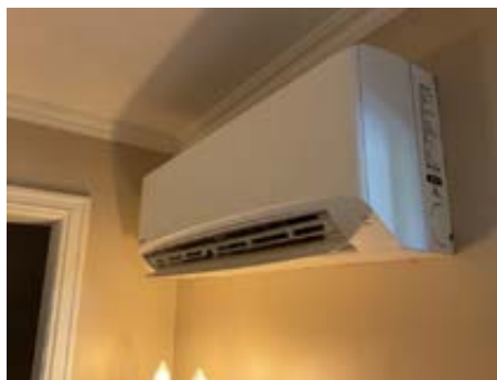
Varmepumpe i sokkeletasje fra 2024.
