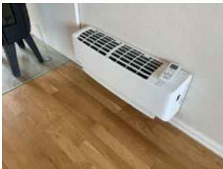
Varmepumpe i stue fra 2019.
