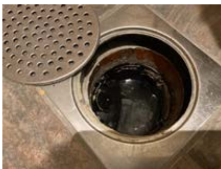
Hjelpesluk ved innredning.
