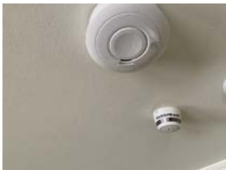
Branndetektorer og brannapparat.
