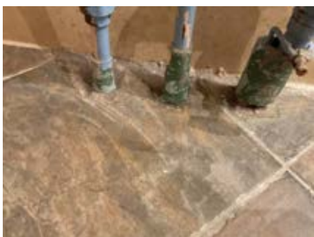
Ikke synlig bruk av rørmansjetter.
