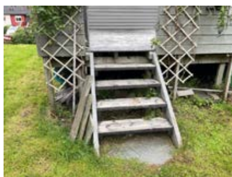
Utvendig åpen tretrapp fra terrasse ned til plen/grøntområder.
