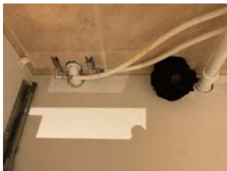
Ikke synlig bruk av rørmansjetter.
