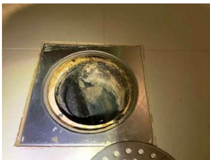
Sluk bad 1.etasje
