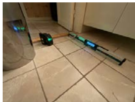
Rikelig med fall fra døren i retning sluk.
