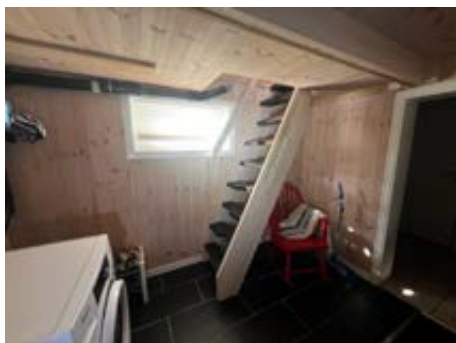
Trappen mangler rekkverk.
