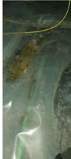
Bilde 2 Tilførselskabel er ikke festet.
