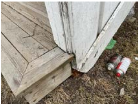
Råteskader flere steder
