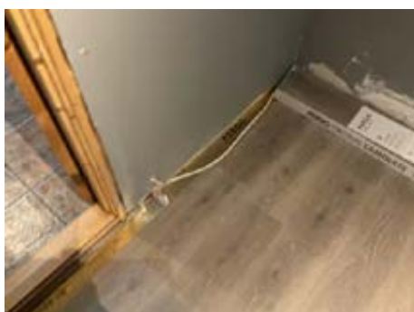
Ikke tilstrekkelig festet
