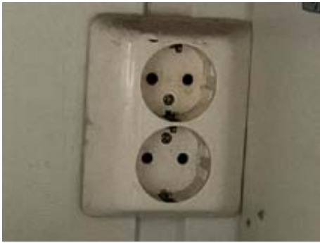
Noe varmgang i stikkontakt
