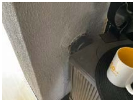
Puss har sluppet noe rundt ovnsrøret
