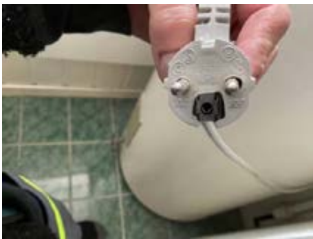
Noe varmgang i støpsel
