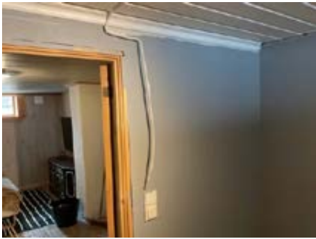
Ikke tilstrekkelig festet
