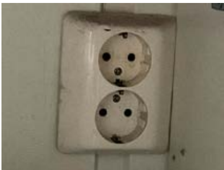
Varmgang i stikkontakt til varmtvannsbereder.
