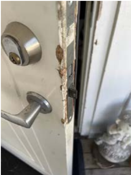
Ytterdør har skader
