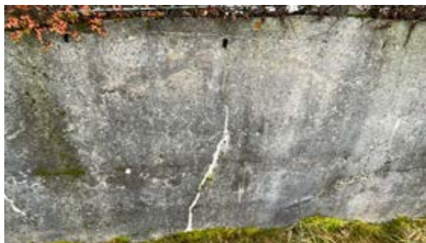
Støttemur mot gaten har sprekker.
