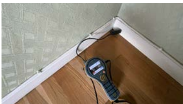
Målt fukt i listen.
