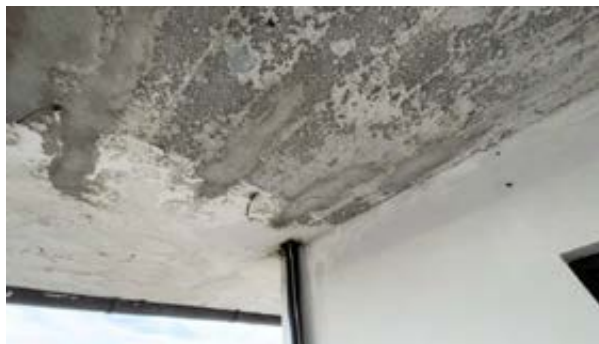
Saltutslag under veranda.
