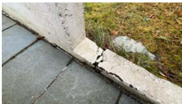
Skade i betong hvor det er åpning i en støttemur.
