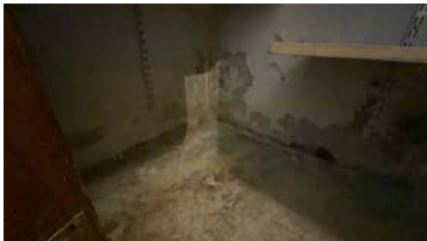
Saltutslag på boden.
