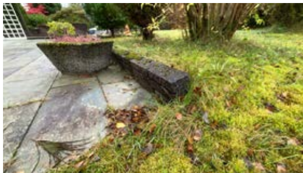
Mindre støttemur bak boligen er skjev og har sprekker.
