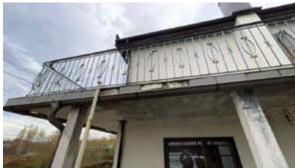
Fliser har falt bort.
