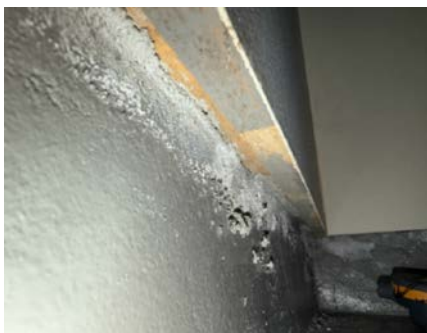
Synlige tegn på fuktgjennomtrengning.
