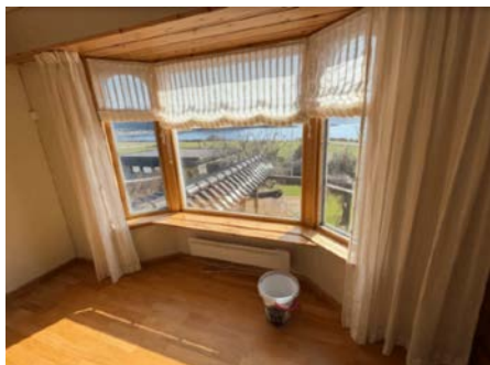
Område det er påvist lekkasje
