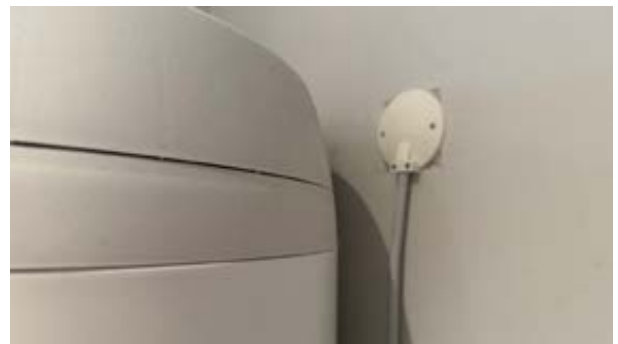
Forskriftsmessig kobling av bereder til elektrisk anlegg.
