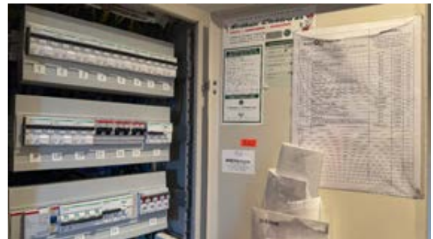
Sikringskap befinner seg i vaskerom U.etg.
