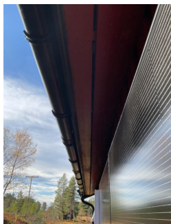
Synlige luftespalter i overgang tak/vegg
