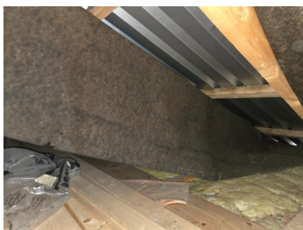
Synlig undertak som henger ned på lagringshems grunnet alder og skade. Kommentert under punktet takteking
