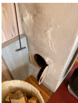
Sotluke og brannmursplate mot vegg
