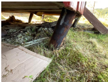
Synlige skjevheter på pilarene
