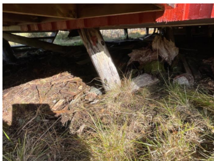
Synlige skjevheter på pilarene
