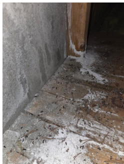
Bildet viser spor etter mus og saltutslag ved pipe på hems
