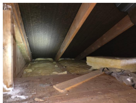
Isolasjon er ført ut til eldre undertak, noe som reduserer luftingen til takkonstruksjonen
