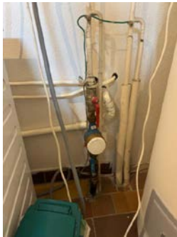
Inntaksrør med hovedstoppekran på vaskerommet nede.
