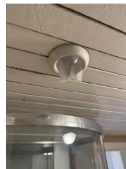
Test av avtrekk. Papiret henger.
