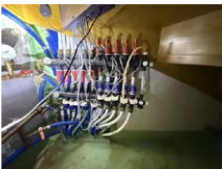
Vannbåren varme i kjeller.
