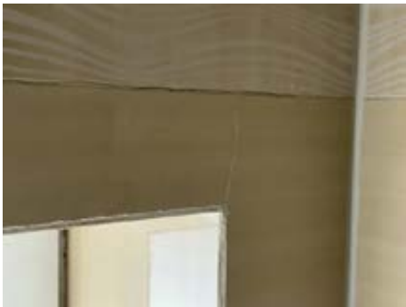
Riss/sprekk i flis og fuge ved vindu.
