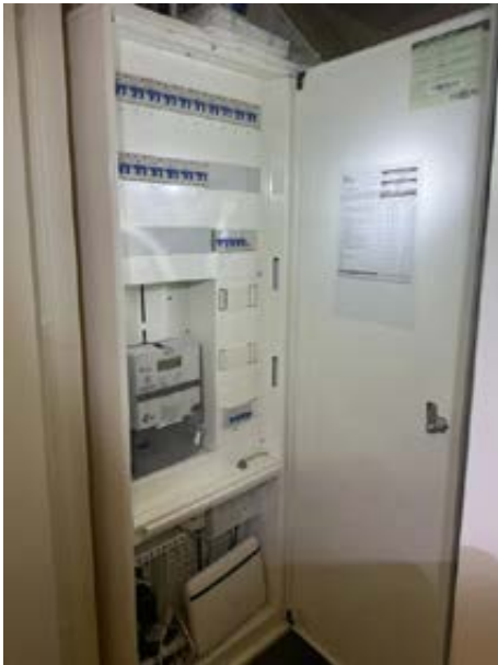
Sikringsskap står i bod/teknisk rom i kjeller.
