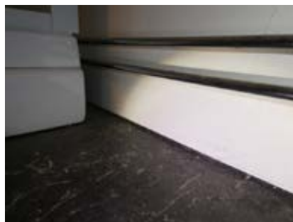
Veggplatene er ikke montert etter monterings anvisning
