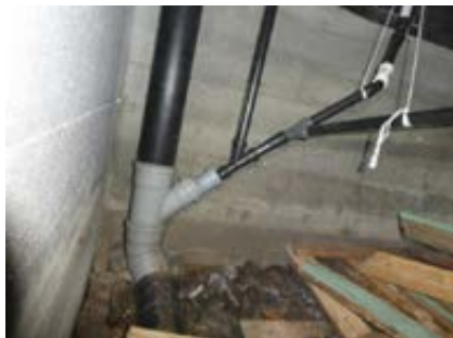
Uegnet materialer og Ikke fagmessig utført
