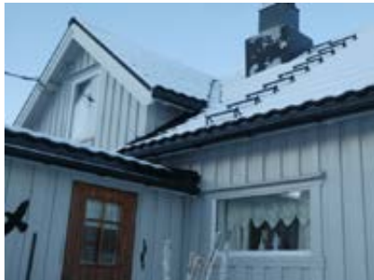
Lakk avskalling på pipebeslag
