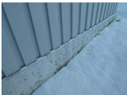
Sprekk i utvendig murpuss
