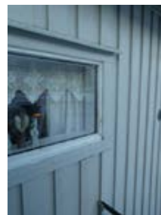
Utvendig tetting ikke helt fagmessig utført
