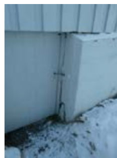
Sprekk i murpuss ved kjellerdør
