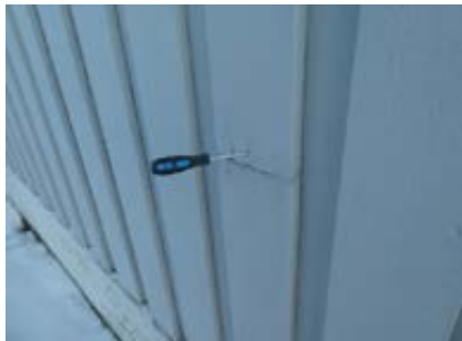
Råteskade i skjøte på kledning
