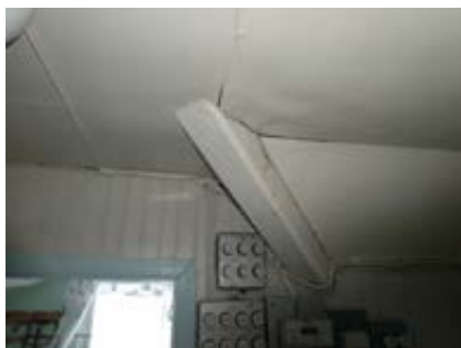
Gammel fuktskade loftsgang
