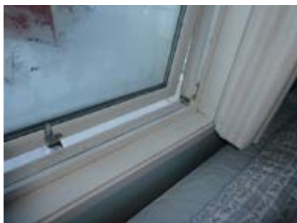
Vindu med punktert glass
