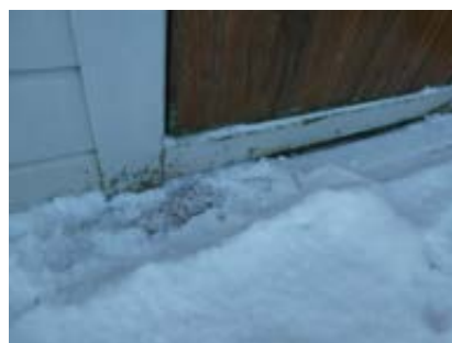
Beslag under dørterskel er ikke etablert.
