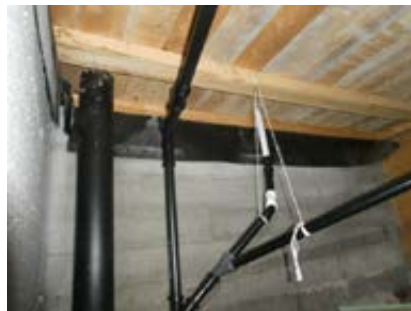
Uegnet materialer og Ikke fagmessig utført
