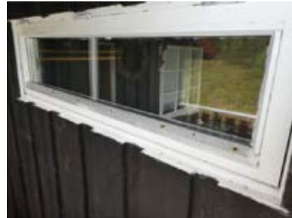
Beslag ikke montert under vindu. Ikke fagmessig utført
