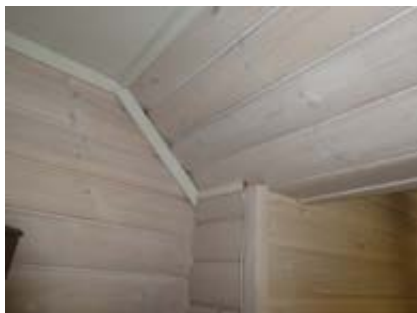
Ikke helt fagmessig utført ifm. belistning
