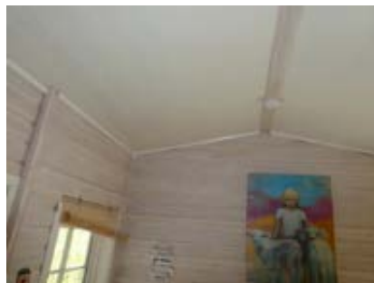
Ikke helt fagmessig utført ifm. belistning
