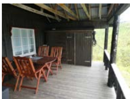
Overbygget terrasse .Rekkverk under 90 cm
