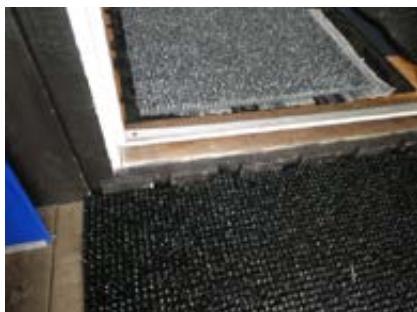
Beslag under terskel er ikke montert. Ikke fagmessig utført
