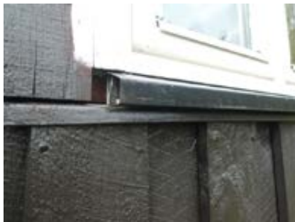
Ikke fagmessig utført
