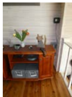
Styringspanel og 2 batterier montert i stue
