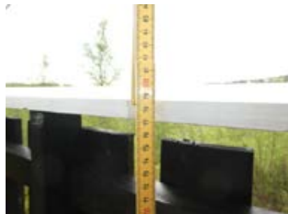
Rekkverk under 90 cm
