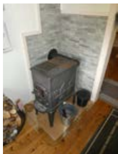
Ildsted kjøkken. Glassplate under ovn må justeres frem mot ovnsluke
