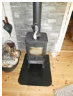
Ildsted stue med underliggende plate
