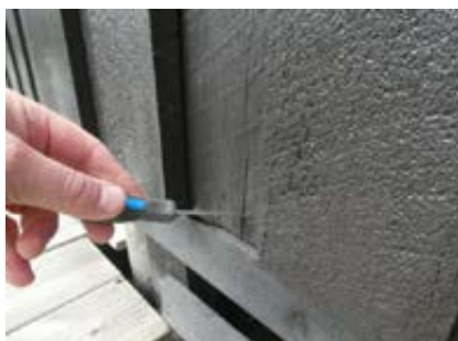
Stedvis slitt kledning
