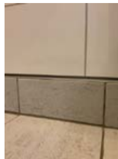
Ikke fuga mellom plate og bunnprofil.
