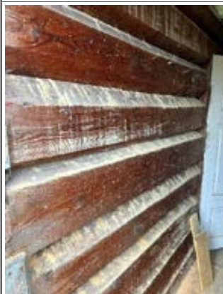
Store mengder boremel på tømmer og gulv
