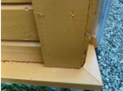
Råte i hjørnebord tilbygg øst
