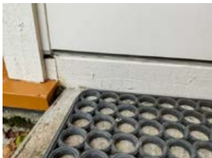
Ikke beslag under dør mot nord
