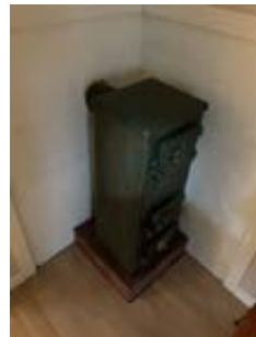
Jøtul 507, mangler plate, pipe nord
