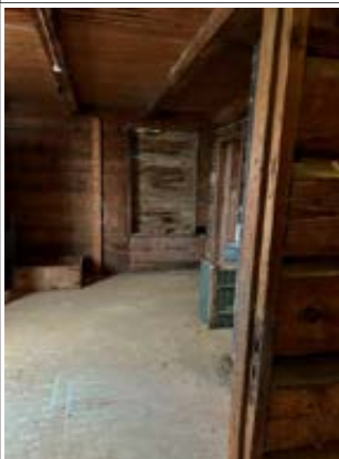
Enkel/uisolert bygning, lysskimt fra gjenkledde vindu, boremel på gulv. Fuktskade konstruksjoner (lekkasje tak).
