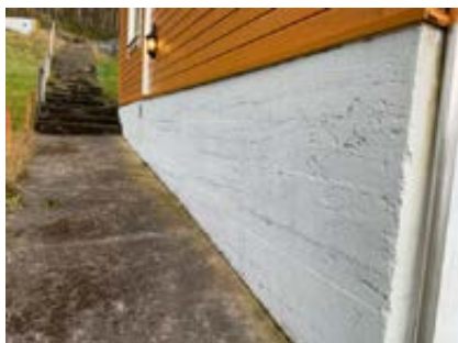
Bordforskalt, påstøyppt, sprekker/riss
