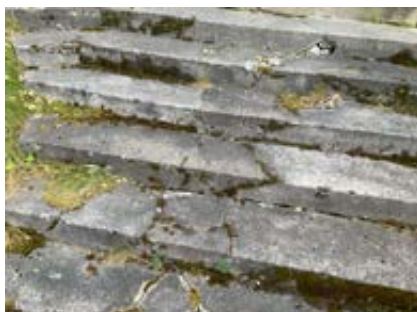
Sprekker i betongkonstruksjoner
