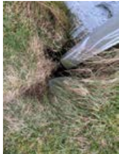
Manglende bortledning fra bygningen
