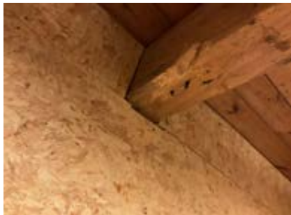
Bjelke i etasjeskille med skader etter borebille/mott
