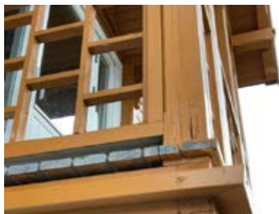
Fukt/råteskade nedre del søyle
