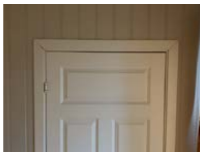
Dør mellom gang og stue nord tar mye i karm
