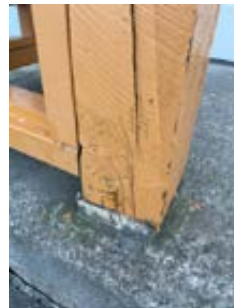
Fukt/råteskade nedre del søyle
