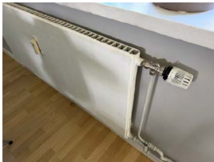
Eldre radiatorer og rør
