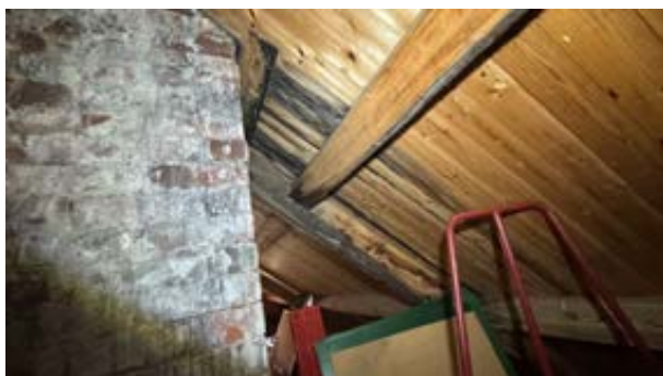
Synlige skjolder etter tidligere lekkasjer på nedsiden av pipens taggjennomføring. Områdene er tørre i dag.
