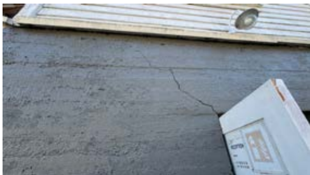
Sprekk over dør.
