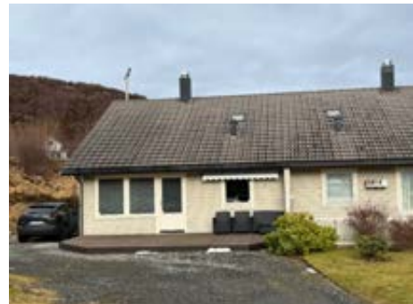
Manglende snøfanger på tak.
