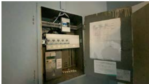
Sikringsskap i felles gang/trappeareal.
