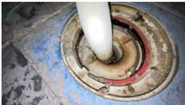
Plastsluk med synlig tettesjikt under klemring.
