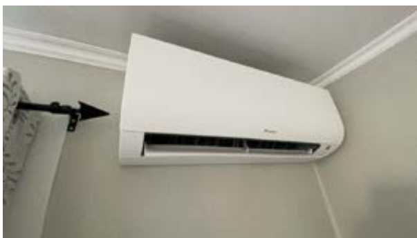
Luft til luft varmepumpe. ontert høsten 2024.
