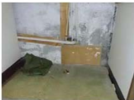
Usikret kabelgjennomføring fra garasje
