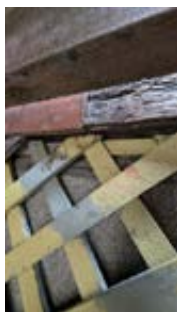
Fuktskaded tømmer sett fra utsiden under terrassen.
