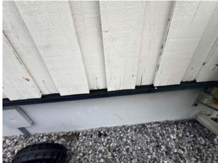
Værslitt og dårlig vedlikeholdt.
