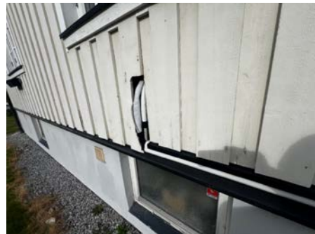
Stor åpning i veggen for rørgjennomføringen til varmepumpe.
