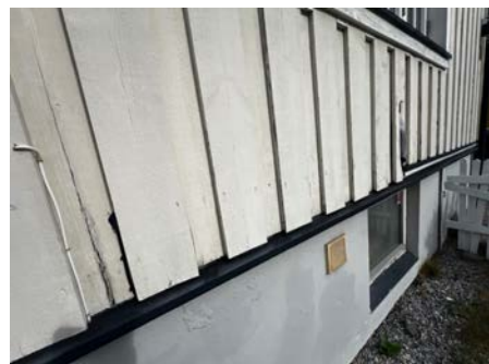
Værslitt og dårlig vedlikeholdt.
