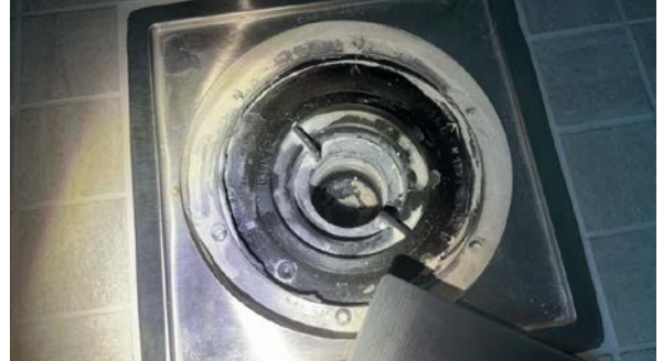
Sluk i dusjsone
