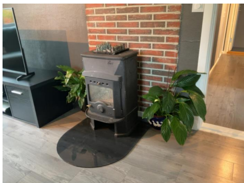
Vedovn med glassdør i stue.
