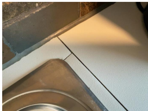
Mindre svellskader i benkeplate ved oppvaskkum.
