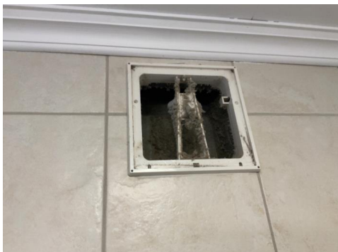
Defekt deksel på klaffventil.
