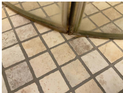
Slitte slepelister under glassdører, må påregnes skiftet.
