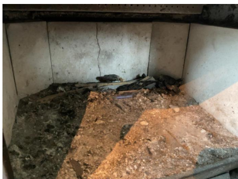
Spekk i ildfast stein, må påregnes skiftet.
