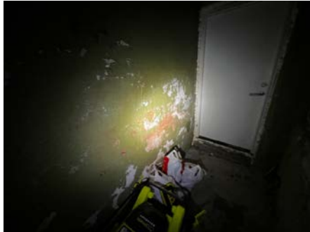
I gangen/entré i kjeller er fukt på grunnmurene på innside.
