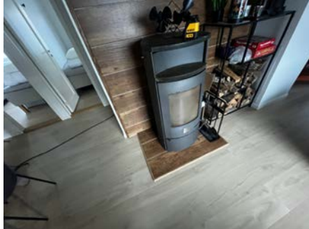
Vedovn i stuen i 1. etasje.
