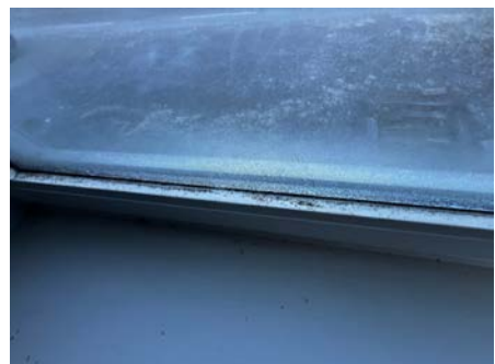
Mugg på innvendig vinduskarm på grunn av kondens.
