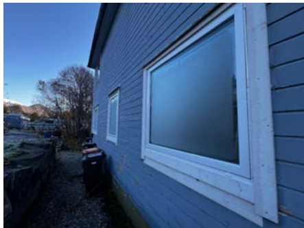
Eksempel på vinduer som mangler beslag under vindu.
