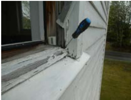
Slitt karm og omramming på de eldste vinduene
