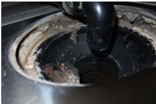
Plastsluk fra byggeår under badekar.
