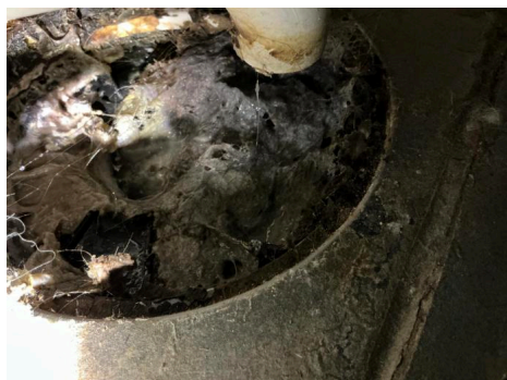
Sluk bad i underetasje
