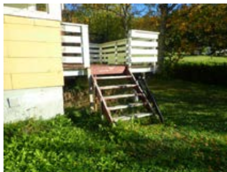
Trapp mangler rekkverk
