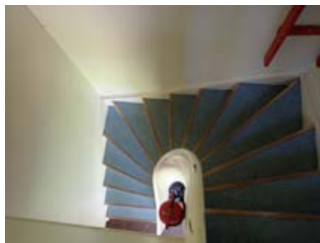
Tretrapp mellom etasjene uten håndlist på vegg
