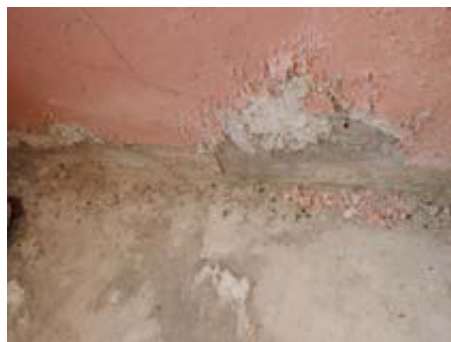
Saltutslag på vegg
