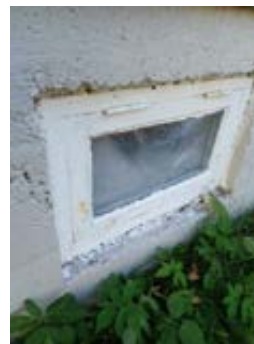
Kjellervindu fra byggeår. Ikke innpusset og ikke underbeslag.
