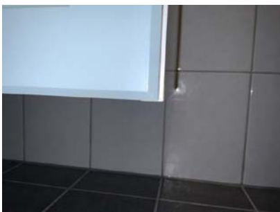
Begynnende svelling på nedre del av baderomsinnredningen.
