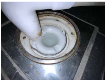
Sluk under dusjkabinettet.
