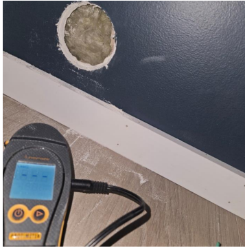
Borret hull i veggen bak dusjen
