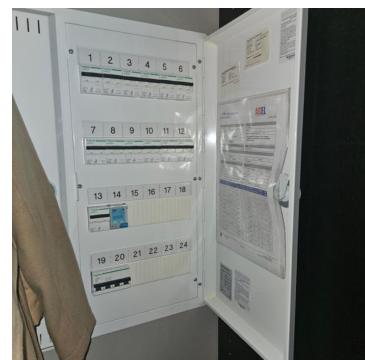
Sikringsskap med automatsikringer og kursfortegnelse
