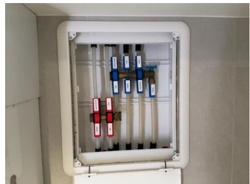
Fordelingsskap for tappevann, med stoppekran
