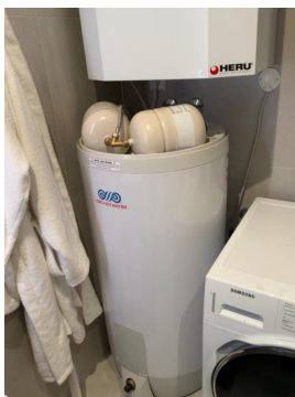
Varmtvannstank med ekspansjonstanker
