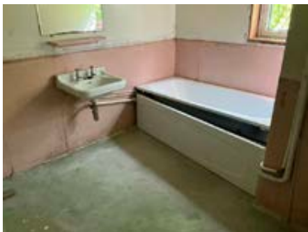
Bad i kjeller
