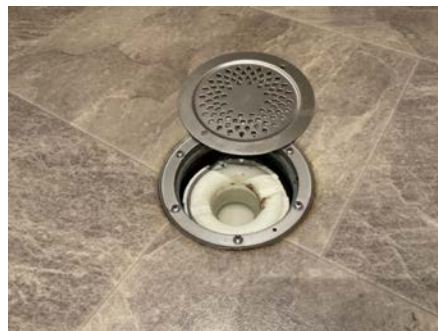
Sluk i dusjsone.
