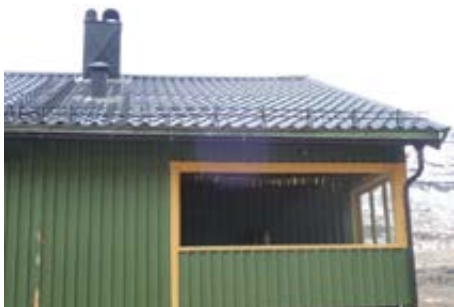
Spillblikk mangler under nytt taktekke.
