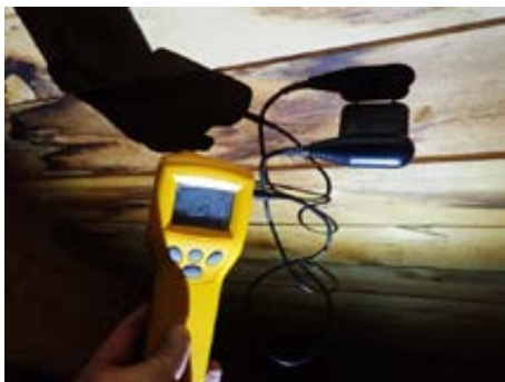
Ca 8 % fukt i trobordene - betegnes som tørt
