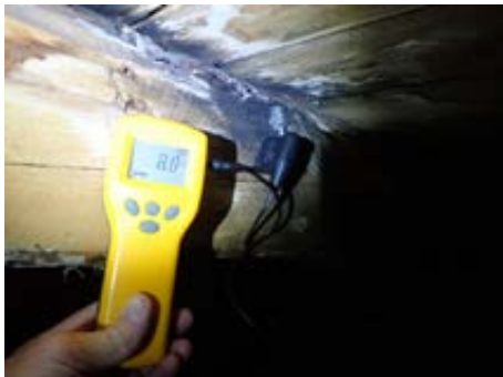
Fuktskadede sperre - Ca. 9% fukt - betegnes som tørt
