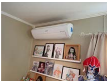
Varmepumpe luft til luft, montert ny i 2020.
