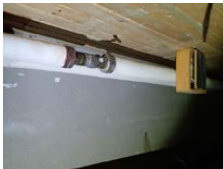
Stoppekran fra byggeår.
