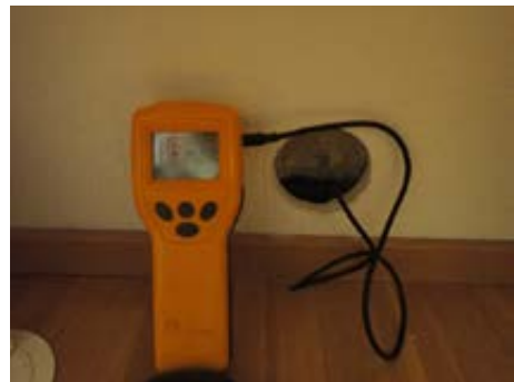
Fuktsøk i badvegg fra bod.
