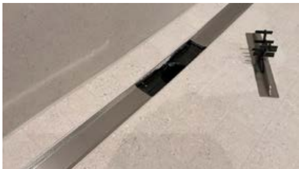
Sluktenne dusj bad 1.etg vest
