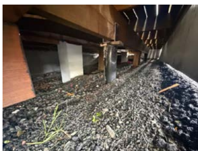
Fundamentering som har seget.
