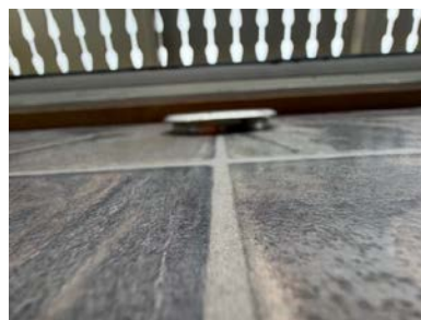
Spotlights som er høyere en gulvet, fare for personskade.
