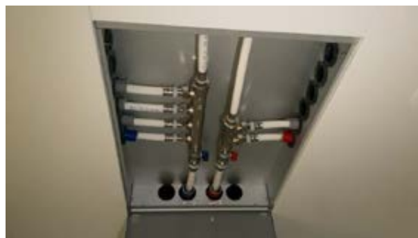
Fordelerskap med rør i rør opplegg. Inspeksjonsluke i himling bad.
