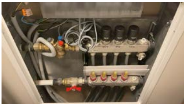
Vannbåren gulvvarme i leiligheten.
