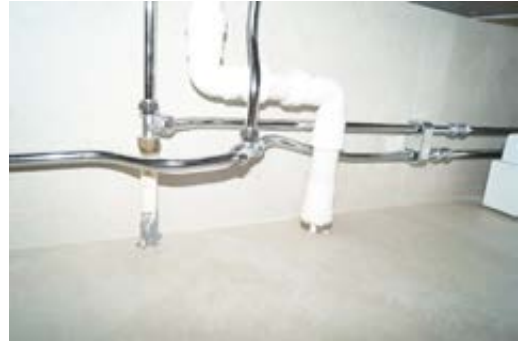
Vannrør ligger synlig utenpå vegg
