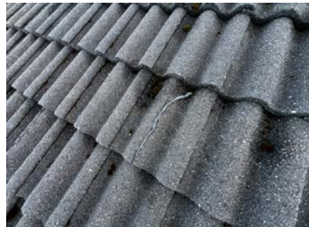
Eksempel på sprukket takstein.
