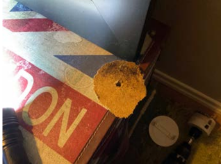
Synlig fukt på veggplaten mot soverom.
