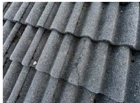
Eksempel på sprukket takstein.
