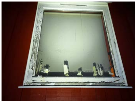
Råte og fuktskadet vindu.
