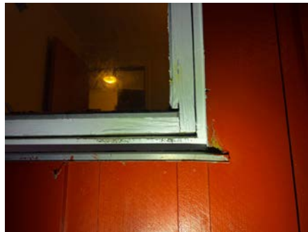
Råteskadet vindu i soverom.
