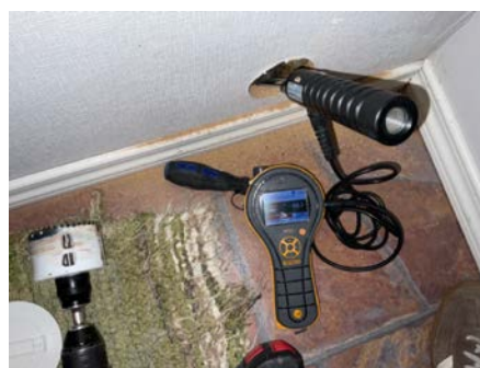
Hulltaking og fuktsøk. Fuktskader i vegggen.
