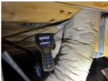
Høyt fuktinnhold i undertaket ved luftelyre. Kan være forårsaket av kondens.
